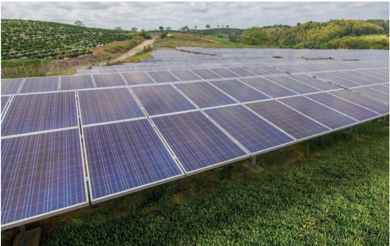
Figura Nro. 4-5: Central solar fotovoltaica Altgenotec (990 kWp), Guayas
